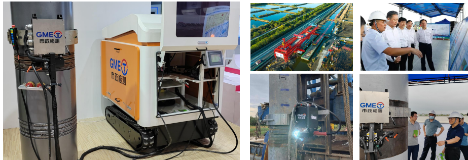
▲成果应用：深汕西高速改扩建梅陇特大桥预制管桩智能焊接
