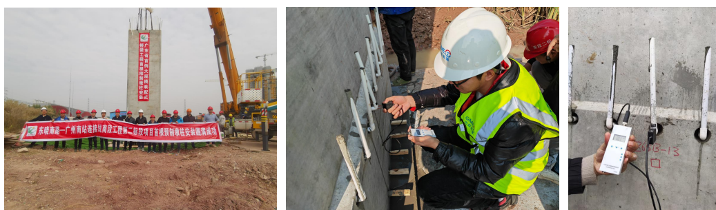
▲成果应用：东晓南-广州南站连接线桥梁套筒灌浆质量检测
